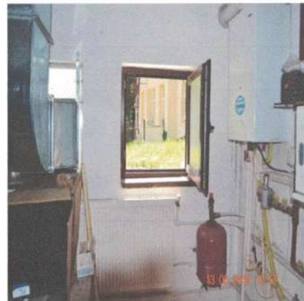
Interior cameră CT
